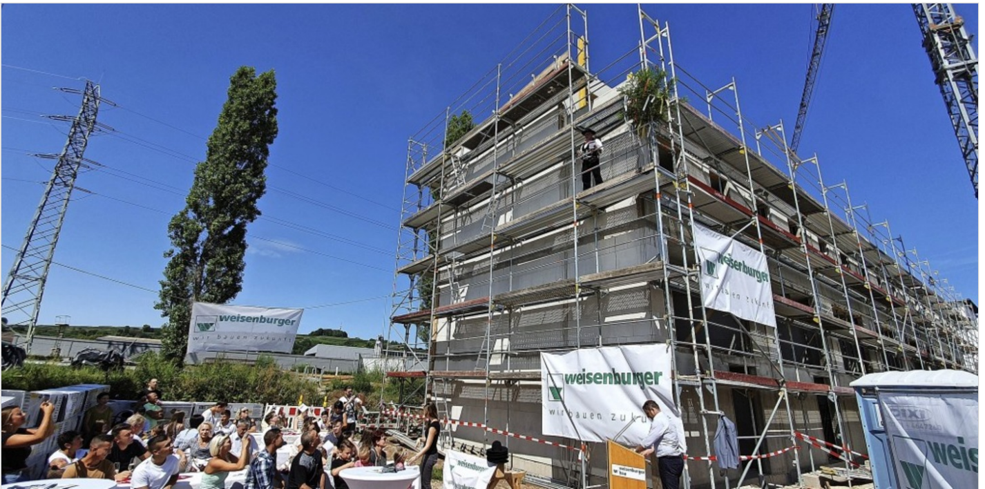
In der Emma-Brauer-Straße in Lahr ist das Richtfest für 15 Einfamilienhäuser gefeiert worden. Foto: Karl Kovacs
